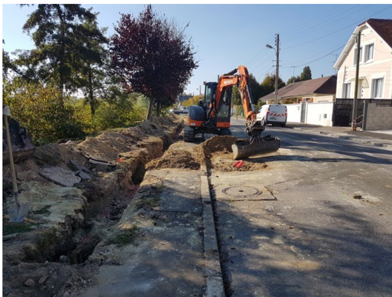
Ci-dessus, travaux en cours : tranchée éclairage pour l'implantation de lampadaires avant réduction de l'emprise de chaussée
